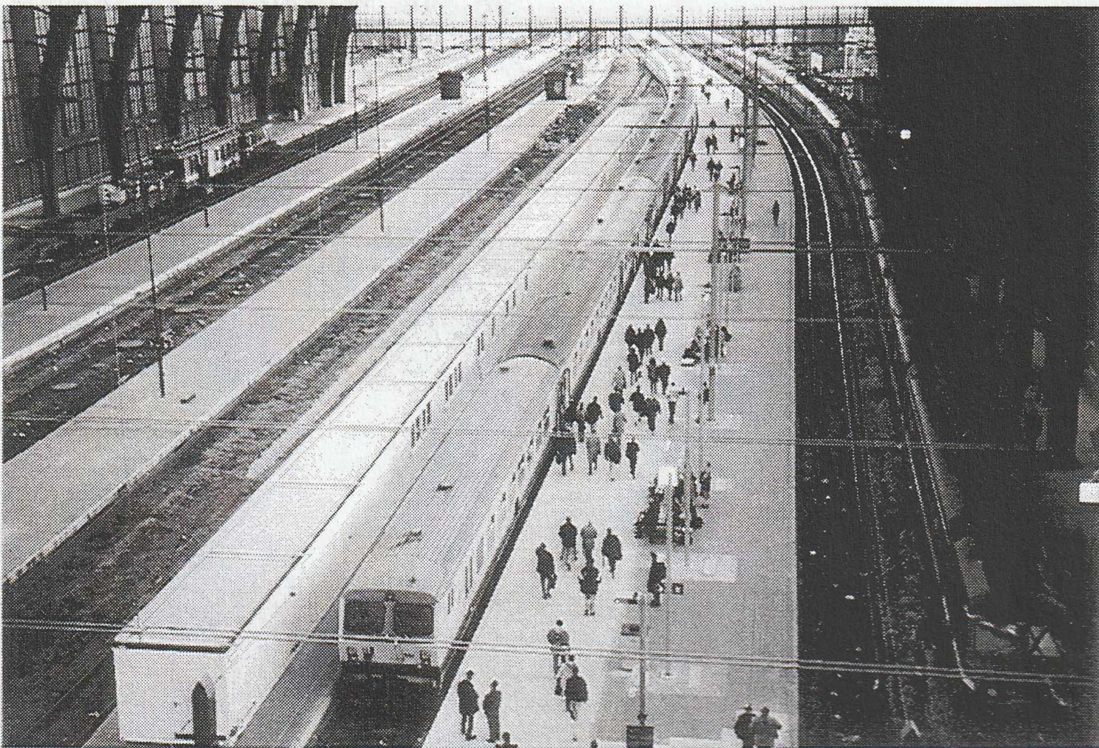
De vernieuwde sporen 1, 2 en 3 zijn in dienst. Achter de containers moet een dienstspoor de afvoer van puin mogelijk maken terwijl op spoor 10 de bovenleiding verder wordt ontmanteld met de hulp van een rangeerloc reeks 84. Antwerpen Centraal 29-10-98. Foto Erik Heylen.
